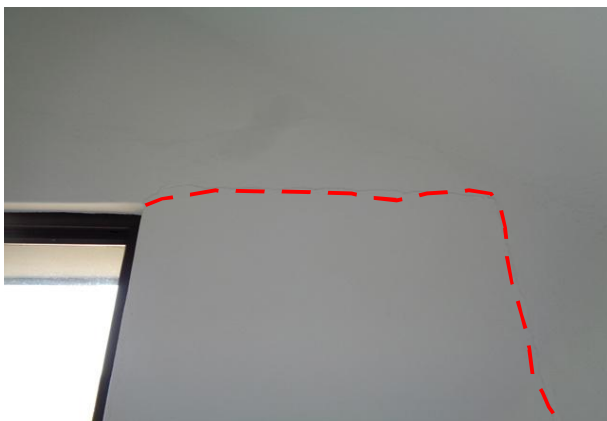
1층 탈수실 벽체 마감 균열 (CW=0.3mm, L=3.0m)
