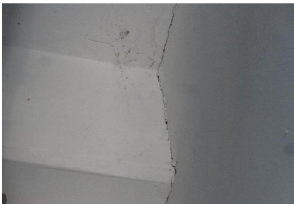
내부 벽체 이음부 들뜸 (A=0.1m×1.0m)
