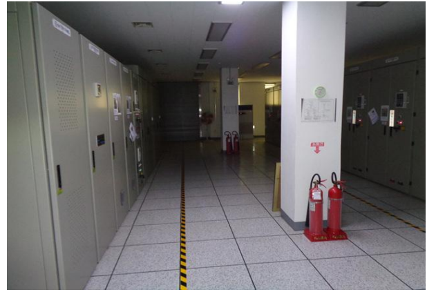
내부 수배전실 전경
