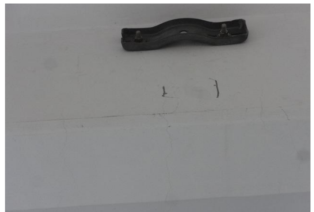
내부 거더 망상균열 (A=1.0m×5.0m)
