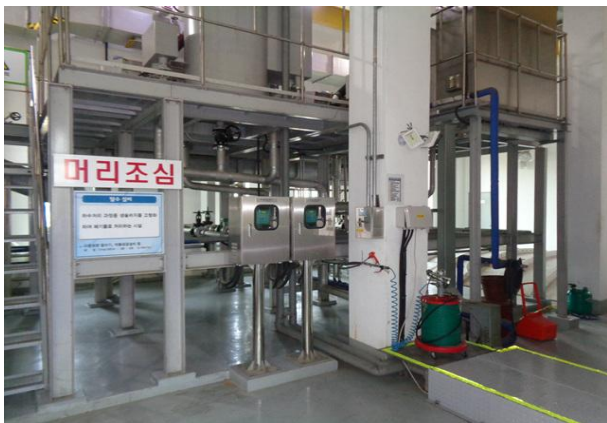
내부 탈수설비 전경
