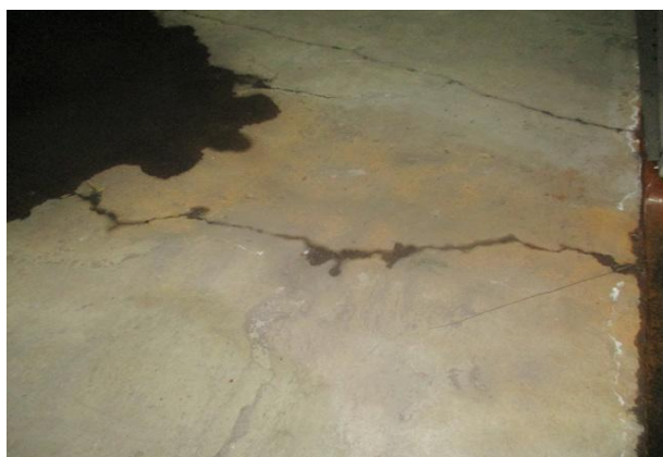
내부 바닥 마감 균열 (CW=1.0mm, L=0.8m)
