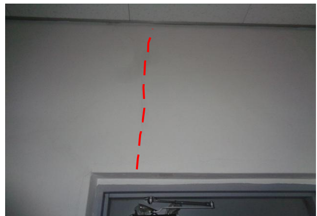
2층 수배전실 벽체 마감 균열 (CW=0.2mm, L=1.0m)
